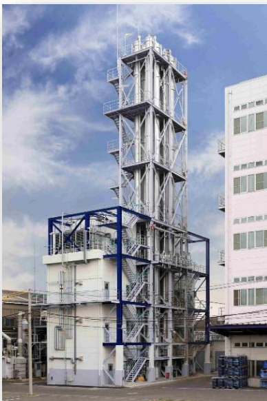
濃縮プラント (大阪府泉大津市)
