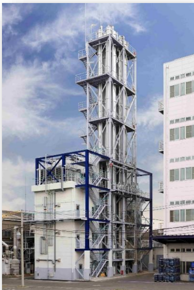
濃縮プラント (大阪府泉大津市)
