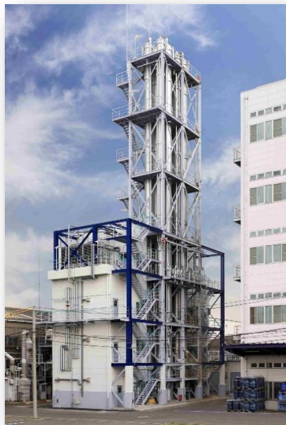
濃縮プラント (大阪府泉大津市)
